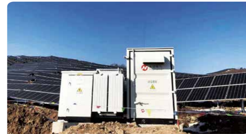
中电朝阳500MW光伏发电平价上网示范项目
