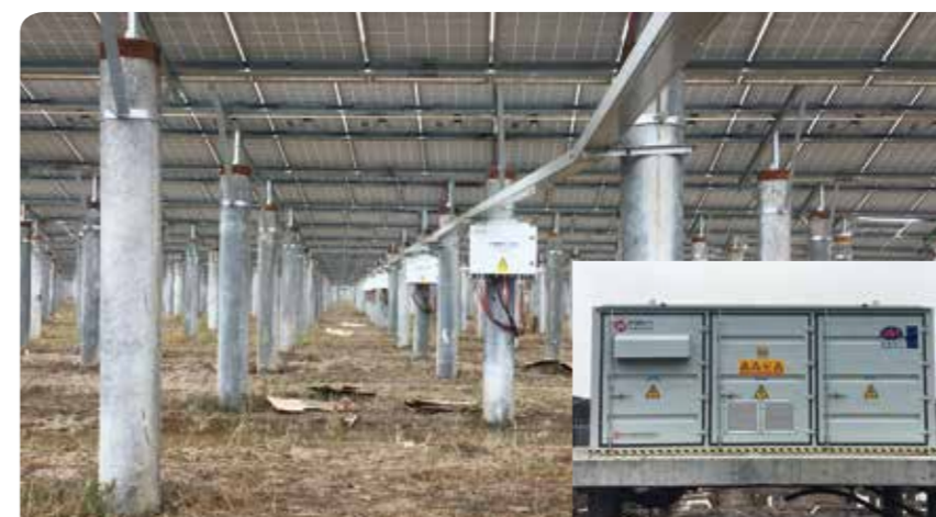
浙江中核汇能宁波市鹤浦镇 30MW农光互补电站
