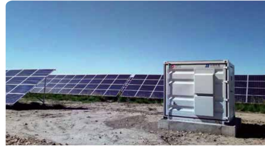
河北华能康宝西滩20MW 光伏电站
