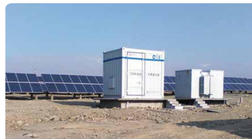
新疆国电投吐鲁番永盛 20MW光伏电站
