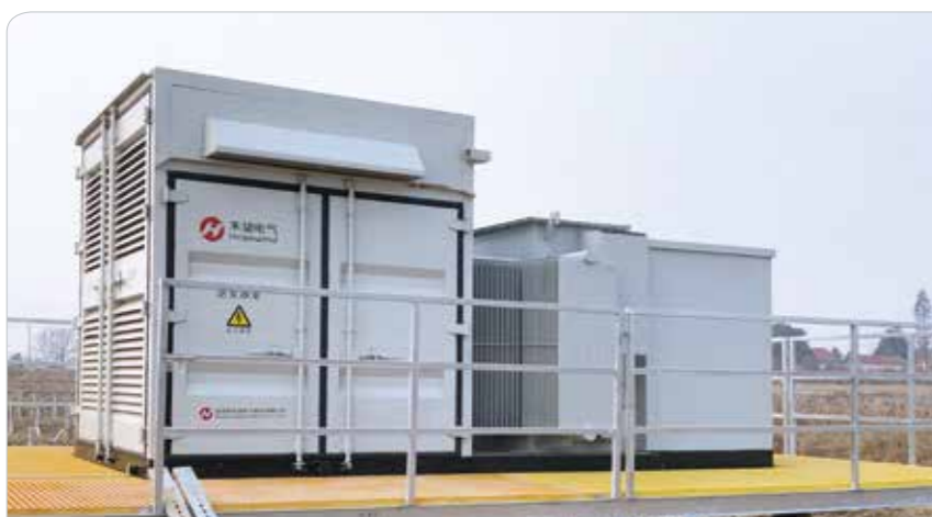
沙洋拾回桥镇兴业50MW 农光互补光伏电站
