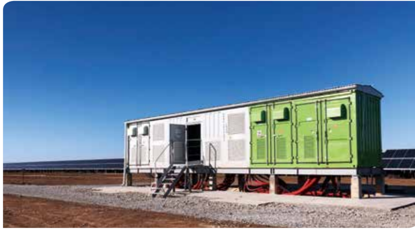
俄罗斯118.5MW Avelar 光伏项目
