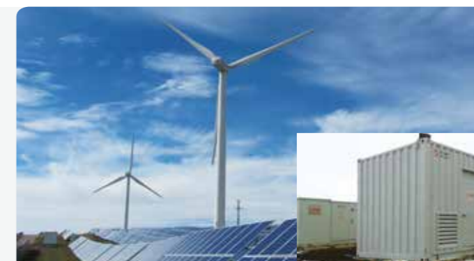
> 内蒙古国电赤峰大于营20MW 光伏并网项目
