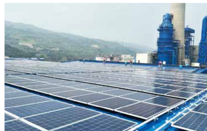
山西汾矿50kW组串式逆变器项目
